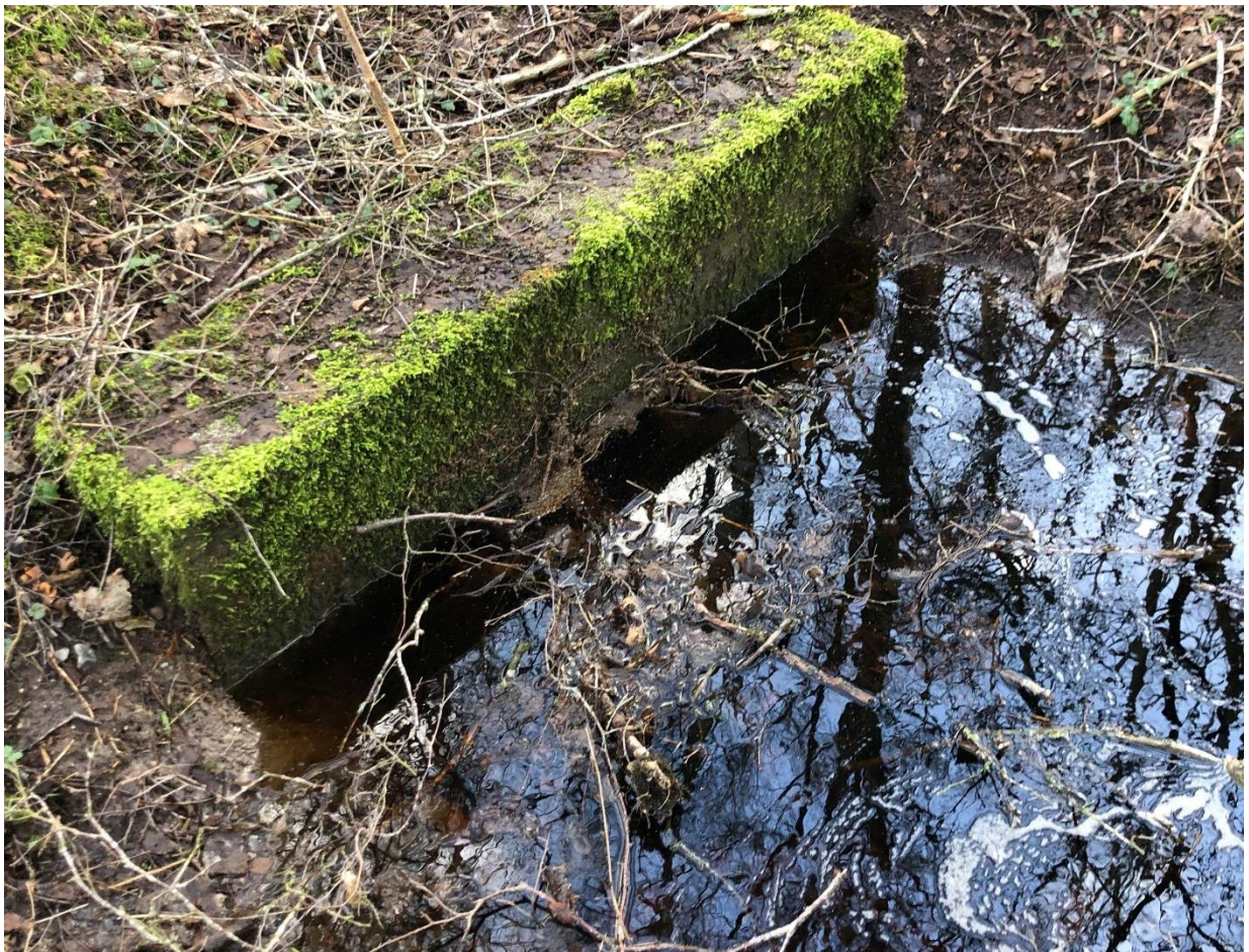
Fig 3. I februar 2022 stod vandspejlet højere end afløbsrørets overkant. Med al sandsynlighed på grund af, at grene og blade havde blokeret dele af rørindløbet.
